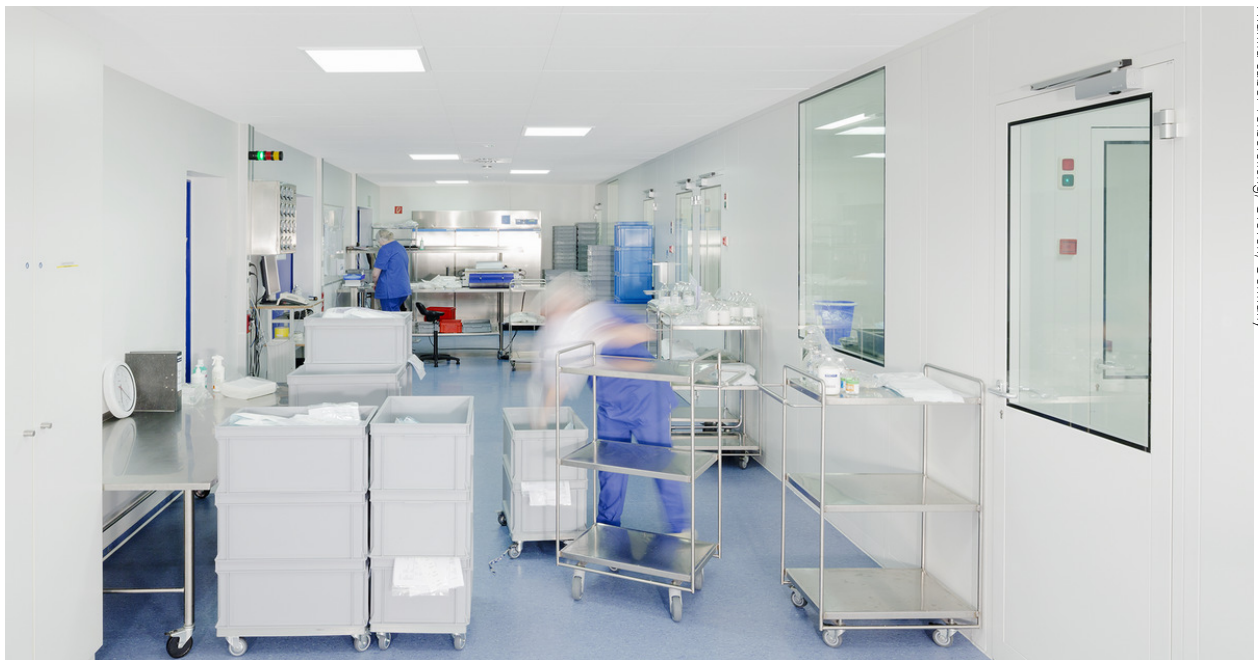
Pharma Labor-Vorbereitung, Greven, Germany
